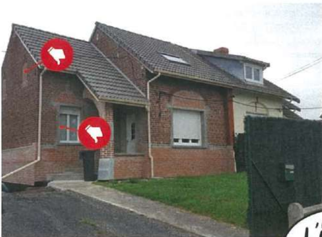
Modification des baies pour s'adapter à des fenêtres standard.
