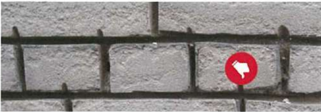
Brique abîmée par l'usage de la disqueuse pour les joints verticaux.
